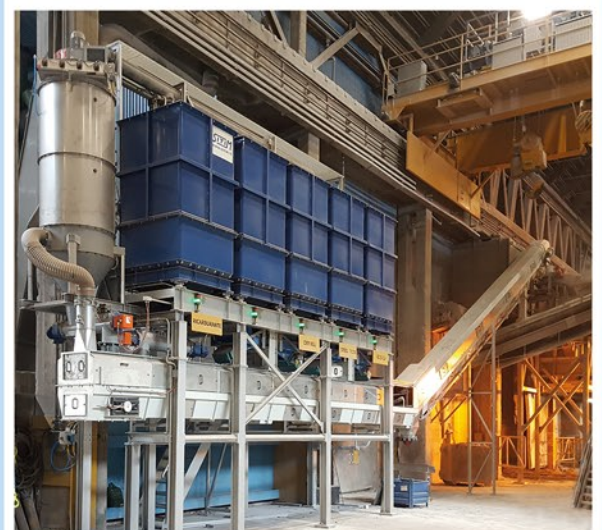
Sistema aggiunta microleghe in LF e siviera Trasportatore chiuso con pulitore integrato Alloys handling to LF and ladle Linear conveyor with in built cleaner
