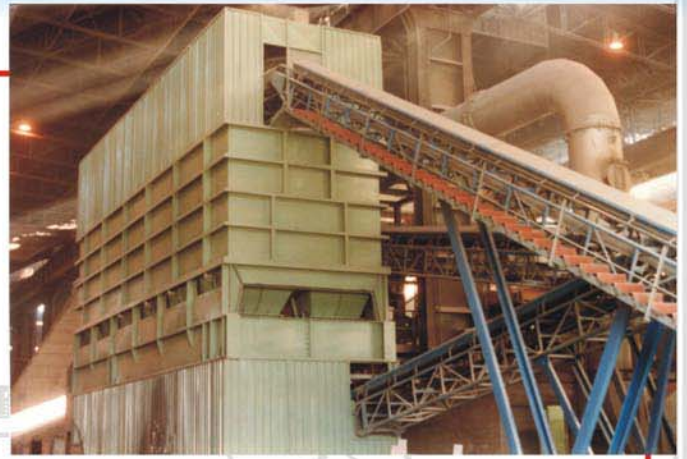
Impianto stoccaggio per materie prime con nastri di alimentazione
