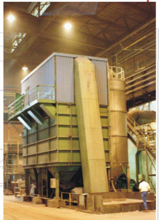
Impianto per additivi con tramoggia di carico, sili di stoccaggio, estrattori e nastri trasportatori
